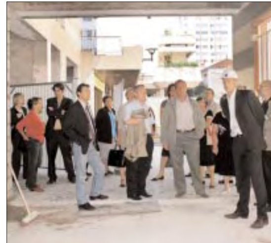
Uli Seher, architecte, présente l'avancement des travaux à C. Dupuy et aux responsables municipaux.
